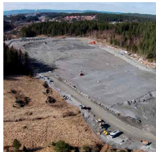
Nyttiggjøring av TBM masser: Oppfylling og tilrettelegging for Gjersrud-Stensrud. Framtidig bydel i Oslo. Foto: BaneNOR
