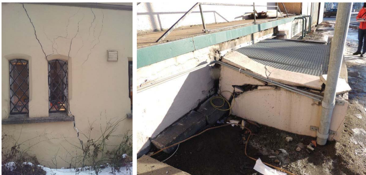
Figur 1-2. Eksempel på setningsskader (venstre bilde: NGI, høyre bilde: SBV-consult).
